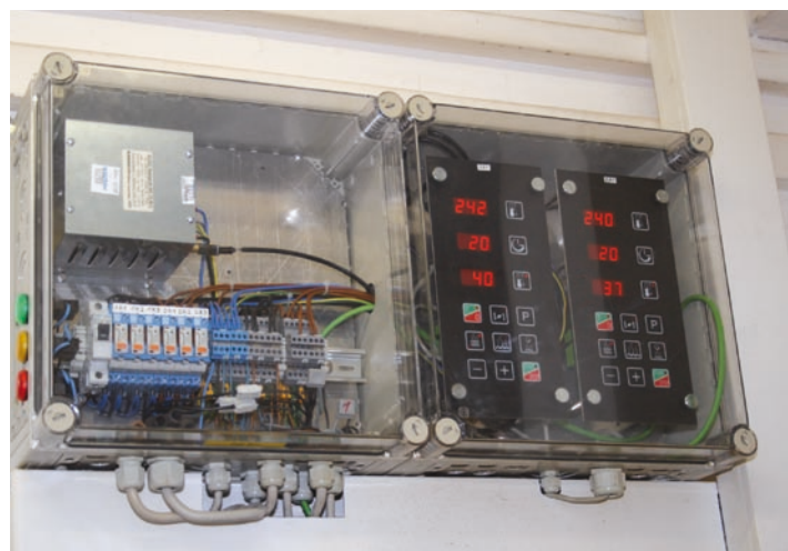
Von diesem Ort aus werden die einzelnen Verbraucher angesprochen und je nach aktuell erreichter Gesamtlast abgeschaltet und getaktet. Durch ein individuell abgestimmtes Prioritätssystem wird verhindert, dass es zu Einschränkungen beim Benutzen des Ofens kommen kann.
